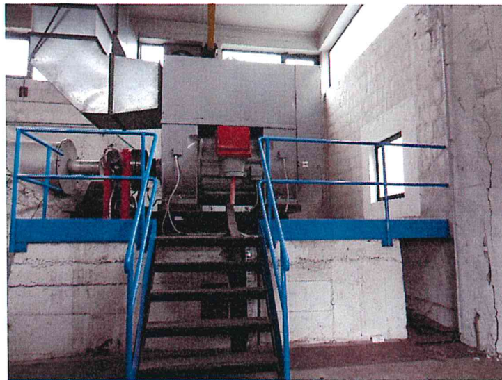
Slika 2: Poškodbe ventilatorska postaja Pesje
