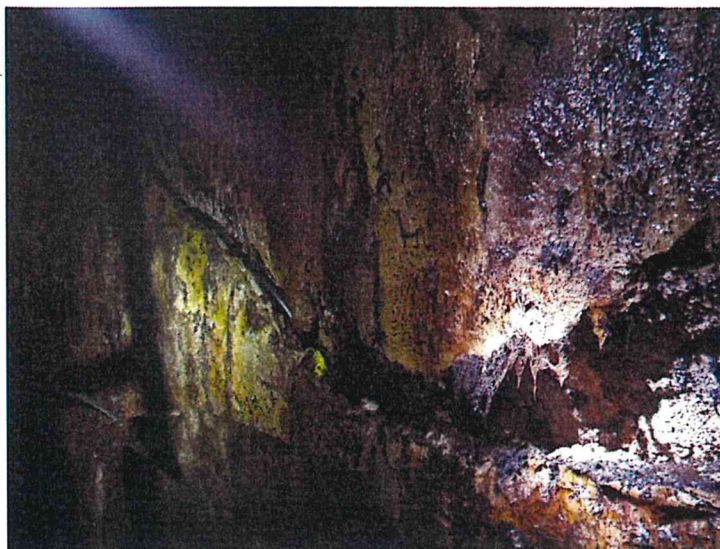
Slika 3: Poškodbe betonske podgradnje
