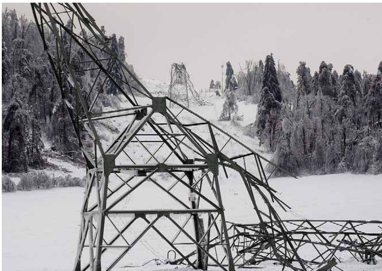
Posledice žledoloma na elektroenergetski infrastrukturi (foto: BoBo, RTV SLO)
