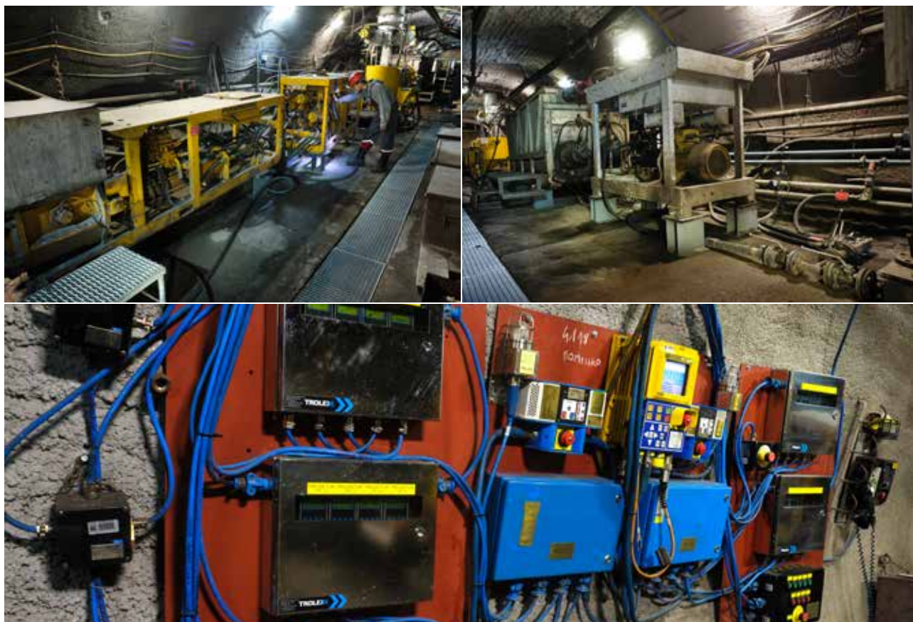
Črpalni liniji za jami Preloge in Pesje (zgoraj) ter nadzorno-krmilni sistem za njuno upravljanje (spodaj) (foto: Miran Beškovnik)
