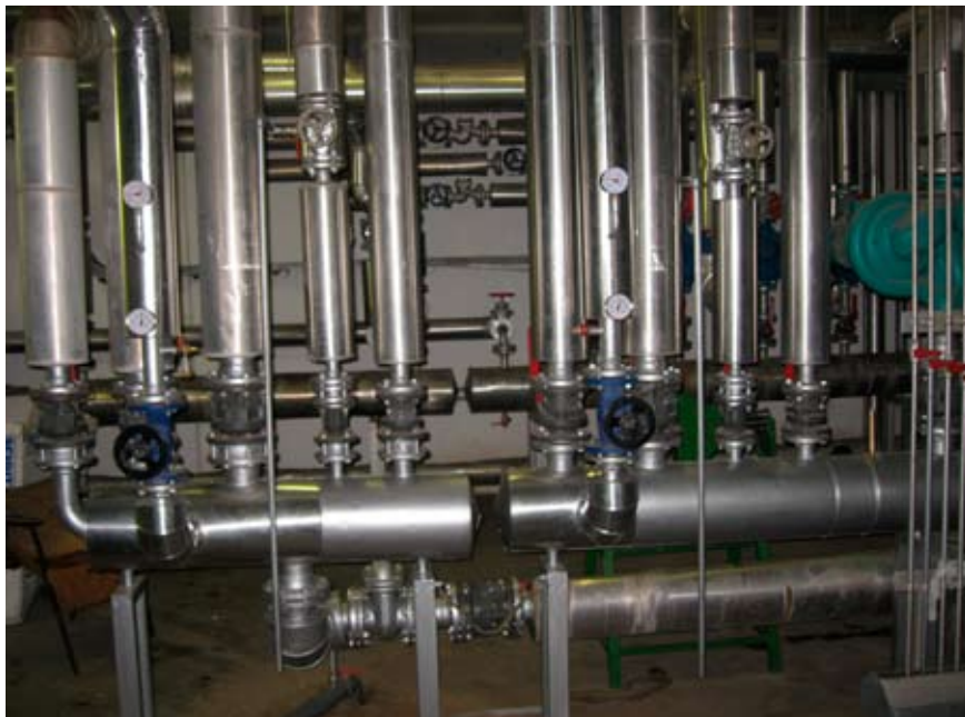
Razdelilnik iz CTPP NOP, ki zagotavlja toploto za klimate garderob in kopalnic.
