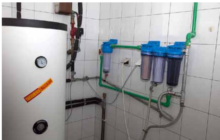
HTZ je prejel diplomu za pripravo izpiralnih vod za zbiralnice mleka, ki s pomočjo vgradnje filtracijskega sistema AquaVallis preprečuje onesnaženje ter zagotavlja 100 % zaščito pred bakteriološkimi okužbami iz vode. (foto Hans)
