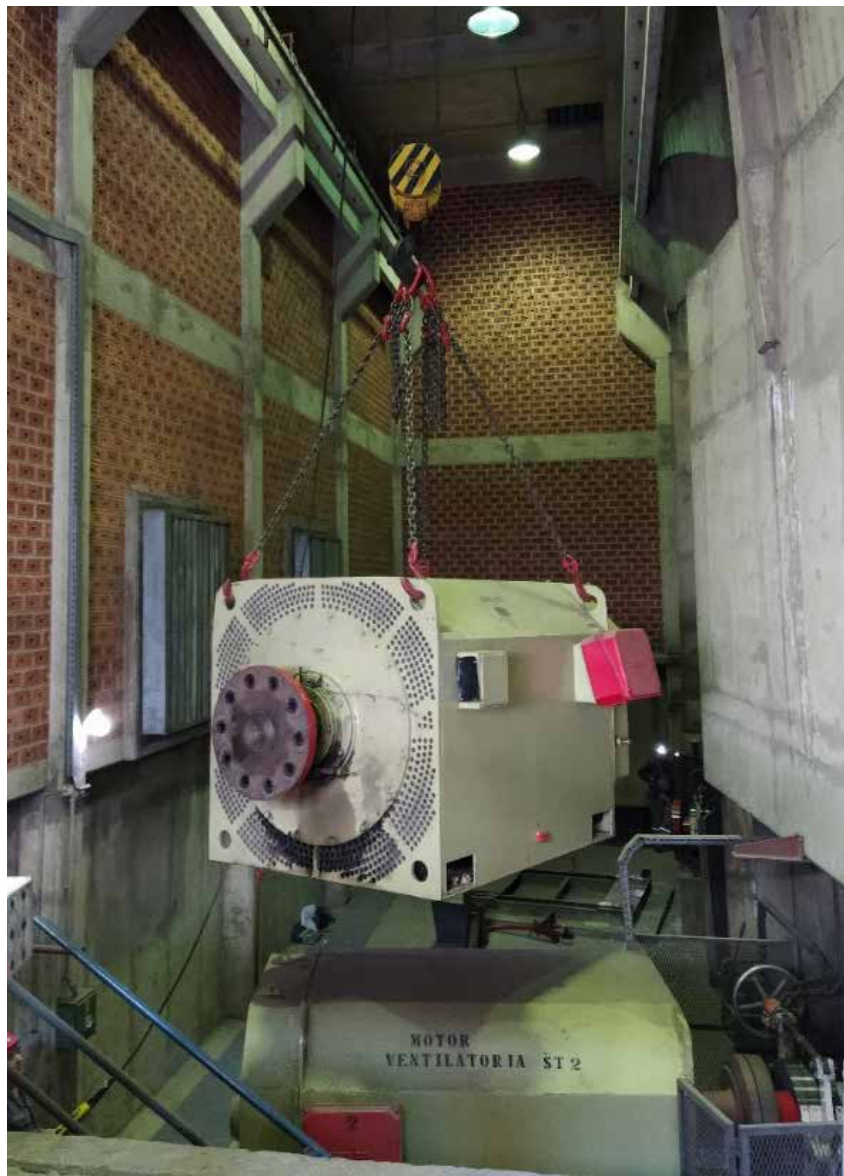
Med 25. in 29. junijem smo pravili načrtovani remont motorja ventilatorja 1 v VP Šoštanj. Enako opravilo na motorju ventilatorja 2 bomo izvedli v dela prostih dneh ob koncu letošnjega leta.
