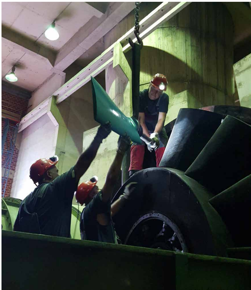
Z menjavo lopatic smo dobili novo obratovalno točko ventilatorja, pri kateri je izkoristek ventilatorja boljši, ob tem pa je tudi manjša poraba električne energije.
