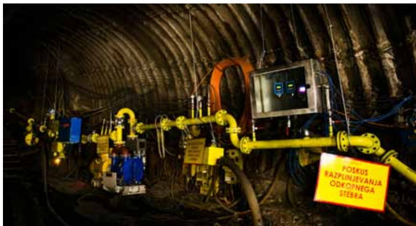
Črpalka za črpanje plina iz sloja s plinovodom in pripadajočo opremo. Za spremljavo parametrov in zagotavljanje varnosti smo namestili merilnike koncentracij plinov, tlaka, temperature ter toplotna stikala. Poskusno črpanje je vsakokrat potekalo pod nadzorom.
