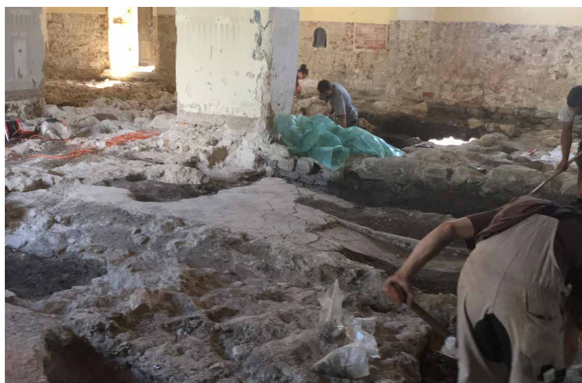
Predvidena so tudi sanacijska dela. Med drugim bo treba sanirati vlago v stenah v celotnem delu stare cerkve. (foto: Ana Kontič)
